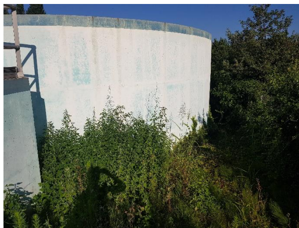
Voile du bassin d'aération
