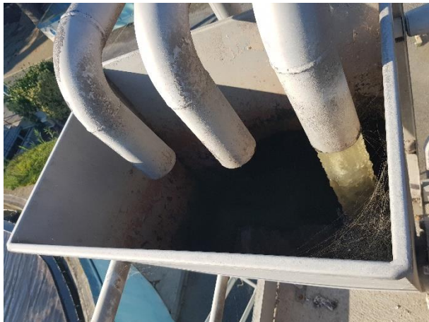
Refoulement poste de relevage
