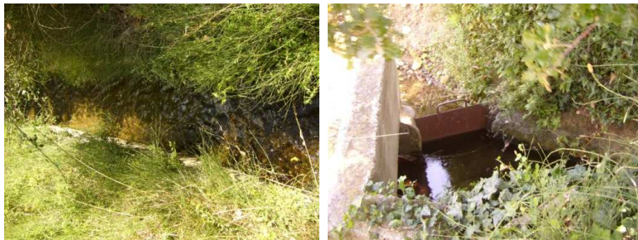
Fig. 6. Canal de Cabira d'arrosage en amont du ravin des Coumes et ouvrage de rejet direct vers le ravin des Coumes (ouverture de la pelle en période de crue)
