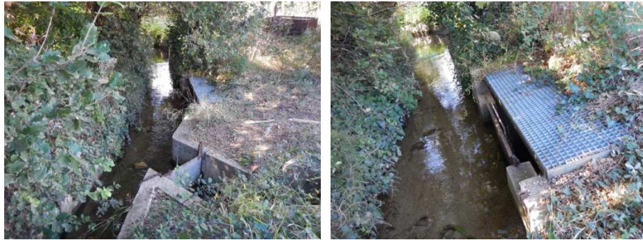
Fig. 10. Canal de Figarolle - Système de gestion au droit de la confluence avec le Campeils - A droite, sortie directe dans le ravin de Campeils fermée en période normale par une vanne
