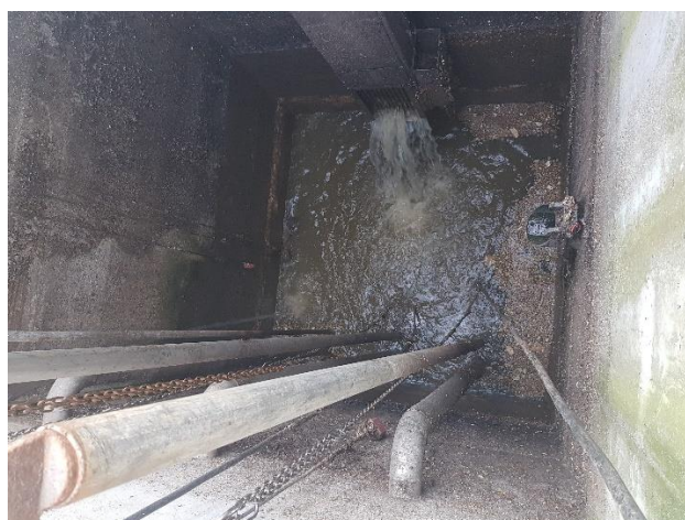
Poste de relevage
