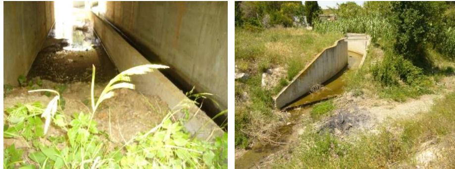
Fig. 8. Canal de Cabira de Collecte et rejet direct dans le Campeils
